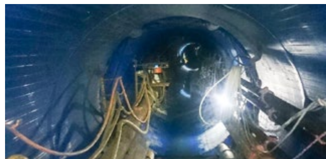
Blick in den mit Polyethylen ausgekleideten Tunnel View of the polyethylene-lined tunnel
