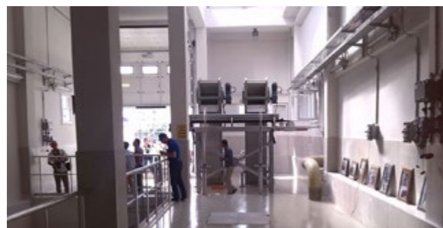
Innenbereich der fertig gestellten Tece Pumpstation Completed Tece Pump Station inside
