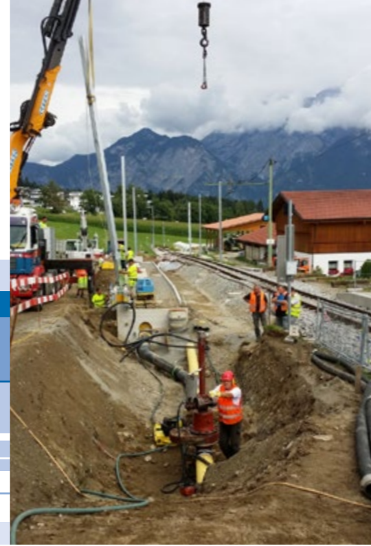
Anbohrung der Stopple-Stutzen mittels Schleuse und Druckluftbohrmaschine Opening up the Stopple nozzles with a sluice and a pneumatic drill
