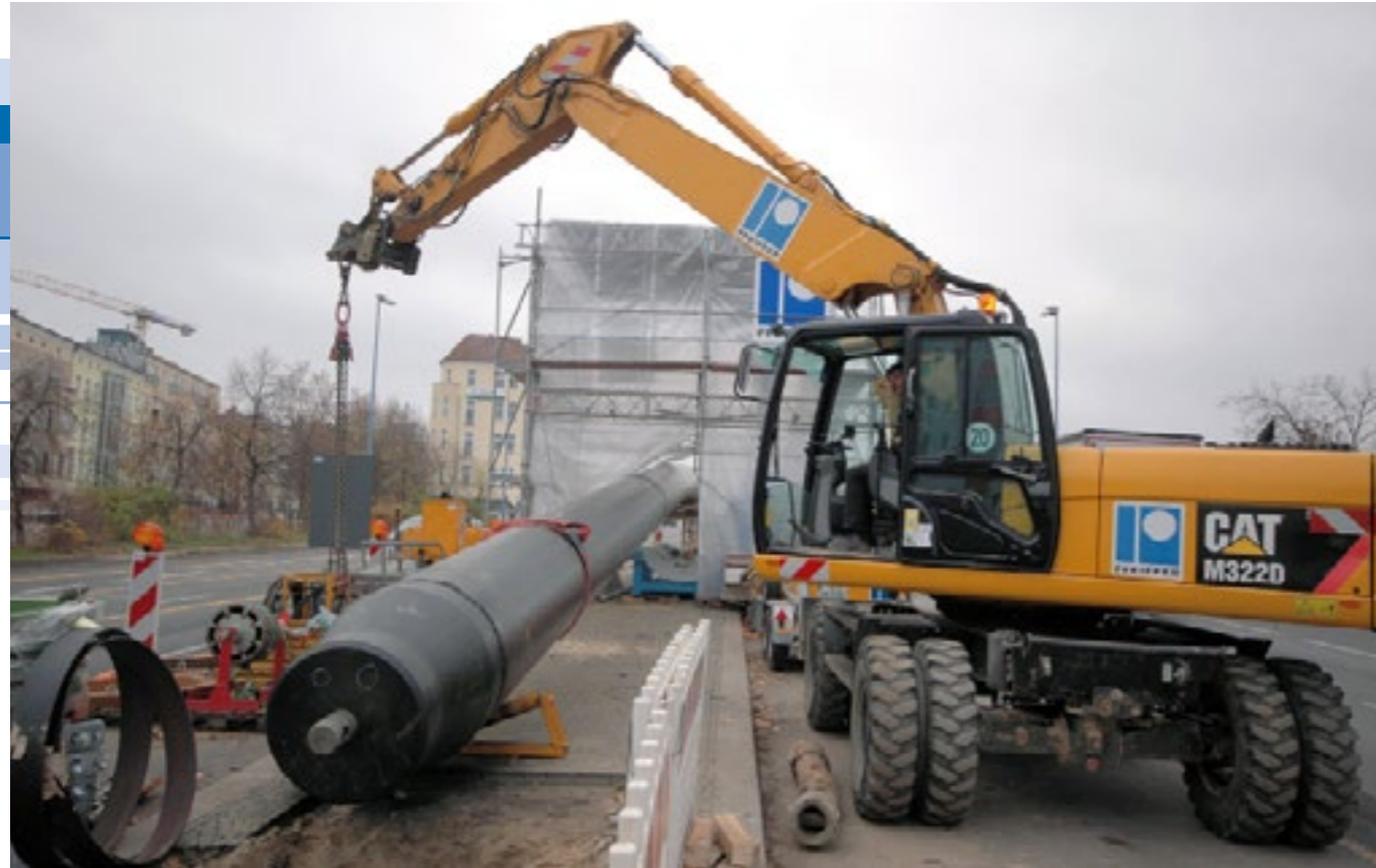
Rohreinzug mitten im Berliner Verkehr Inserting a pipe in the midst of Berlin traffic
