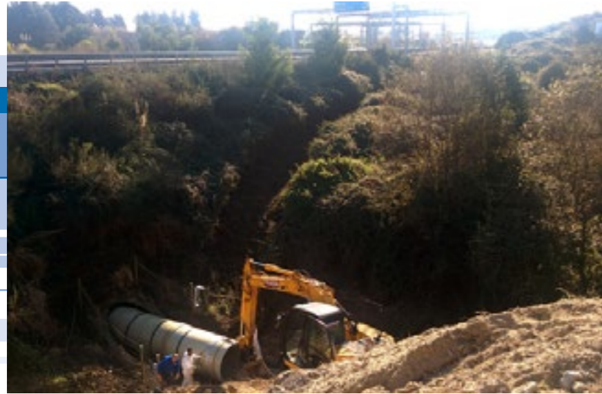
Rohrreueverung direkt unter der Autobahn - offene Bauweise wäre hier keine Option... Pipe relining right beneath the motorway – the open construction method was not an option here
